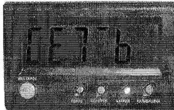
Рисунок 10 – Аварийная сигнализация при пропадании питающего напряжения
