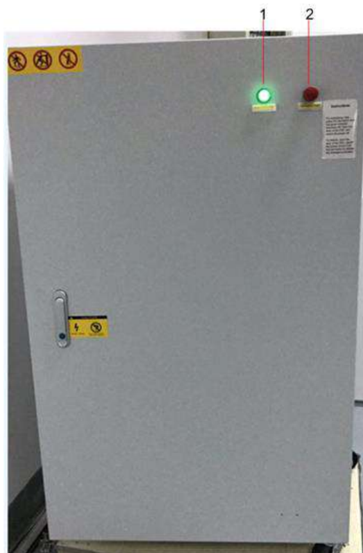
Рисунок - 3 Аварийная кнопка выключения на распределительном щите питания
