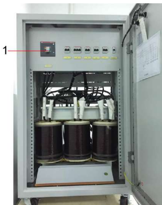
Рисунок - 31 Внутренний распределительный щит питания
